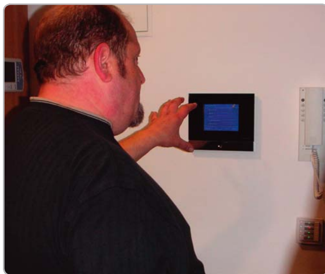
Dotykový panel pro ovládání osvětlení, vytápění, bití zvonů apod. – ze sakristie kostela v Ambergu
