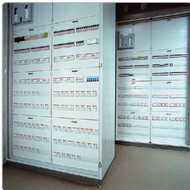
Srdce každé elektroinstalace KNX/EIB – moderní rozváděč (Foto: Radnice Kiel)
